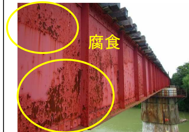
腐食が発生した橋りょう
