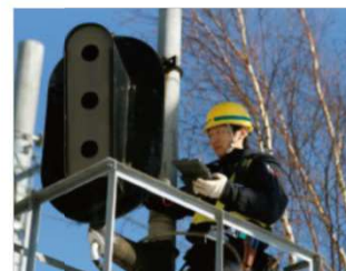
信号・通信設備
