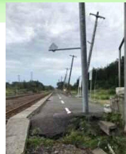
室蘭線 安平駅構内 電柱傾き
