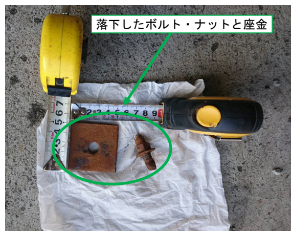
写真 2 落下したボルト等
