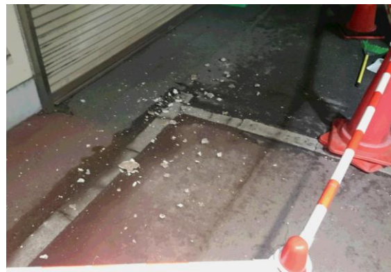
【写真2 剥落したモルタル片】
