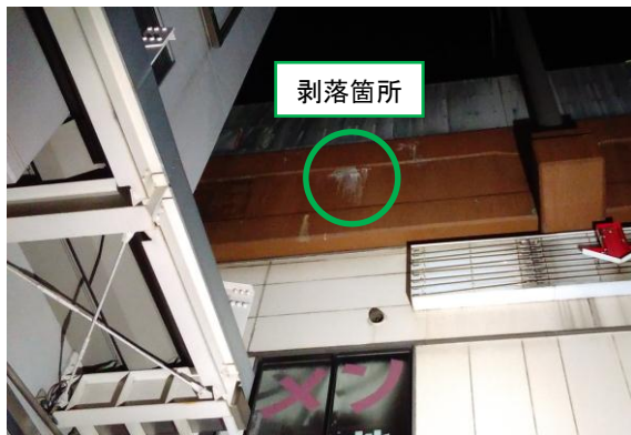
【写真1 剥落箇所】
