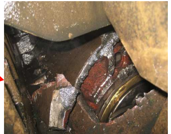
エンジン上部の破損状況 (約15cm×25cm)
