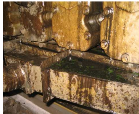
エンジン(進行左側) 潤滑油飛散状況
