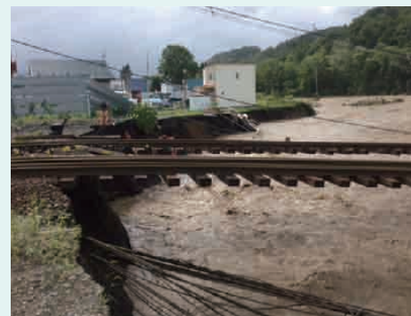
2016年8月、台風10号による橋りよりの流出(下新得川橋りよう)。
