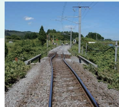
1999年に江差線 札幌～木古内間で発生したレールの「座屈」。
