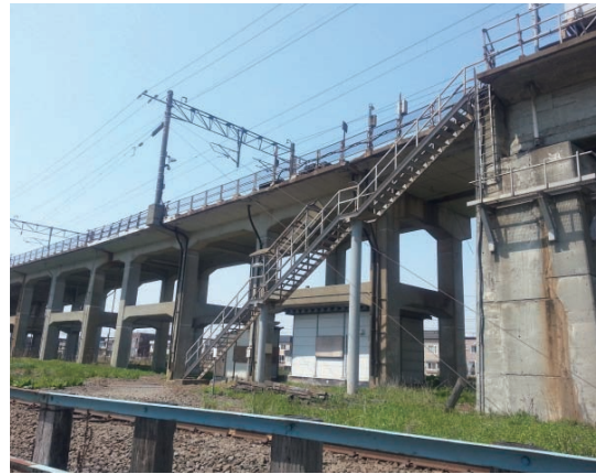
新札幌・千歳高架橋とともに、両高架駅の耐震補強工事にも取り組む予定。
