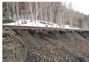
路盤流出の様子
