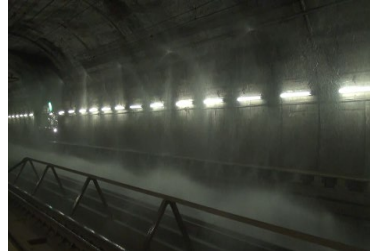
水噴霧装置動作確認
