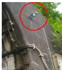
トンネル出入口の照明
