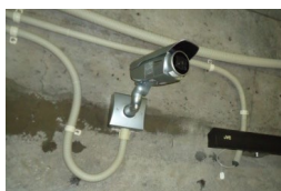
陸底部斜坑のカメラと放送設備
