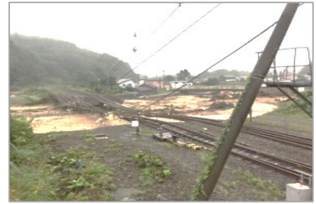
根室線新得駅構内 橋りょう流失（2016年8月）
