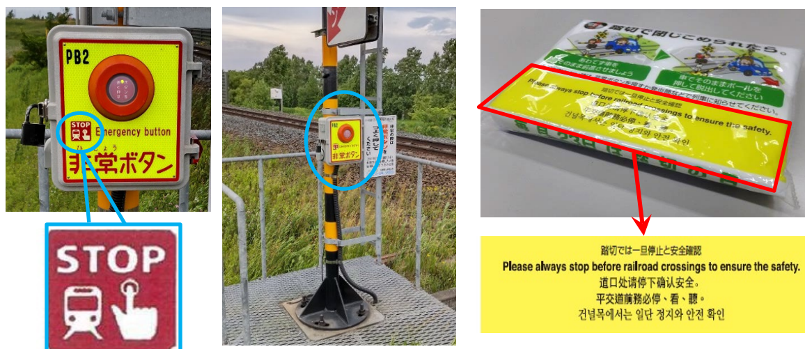
ピクトグラムを表記した踏切非常ボタン(踏切支障報知装置)
