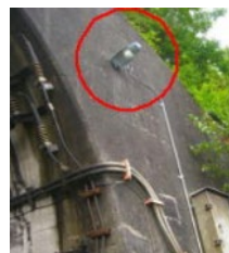
トンネル出入口の照明
