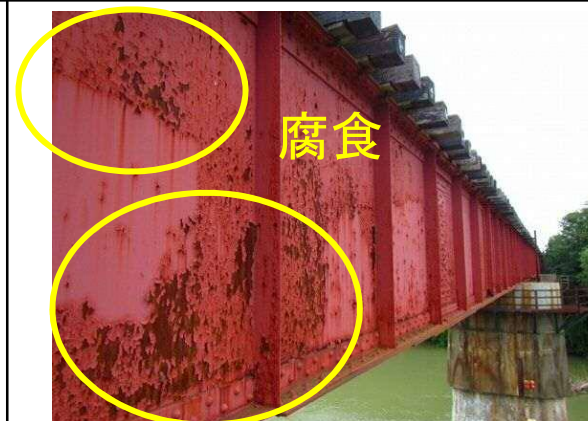
腐食が発生した橋りょう
