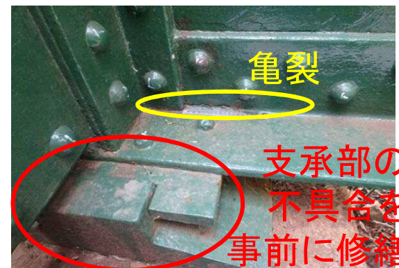
亀裂が発生した橋りょう
