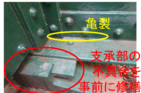
亀裂が発生した橋りょう
