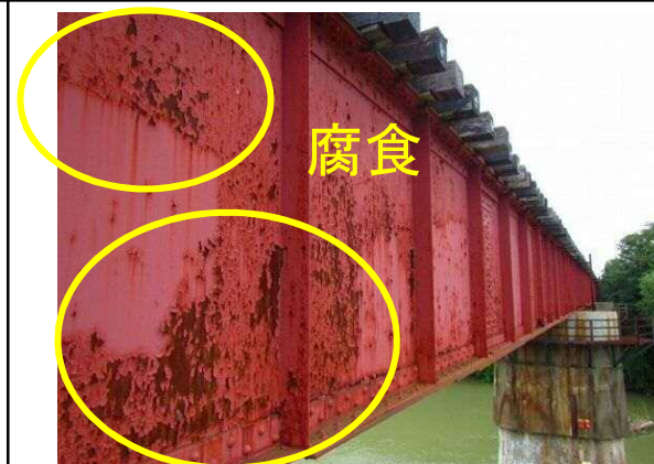
腐食が発生した橋りょう
