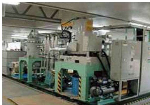
ワックス剥離廃液処理装置
