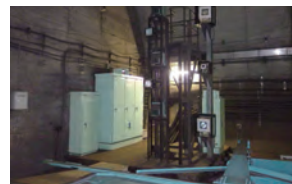
列車火災検知設備(吉岡定点)
