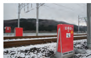
地上消火設備(湯の里知内信号場)
