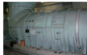
排煙設備(吉岡定点)
