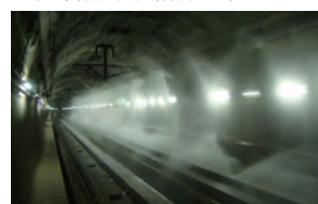
水噴霧設備(吉岡定点)
