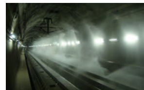
水噴霧設備(吉岡定点)
