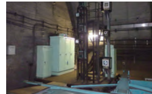
列車火災検知設備(吉岡定点)
