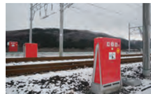
地上消火設備(湯の里知内信号場)
