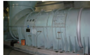
排煙設備(吉岡定点)
