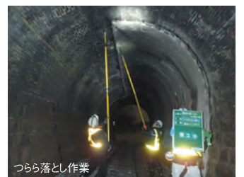
塩谷トンネル [経年、漏水の凍結など] ○経年112年(1913年完成) ○函館線 塩谷～小樽 間
