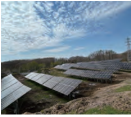
北広島市内の発電所 ※北海道電力(株)及び合同会社HARE晴れ提供
