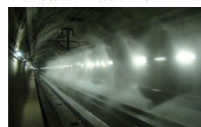
水噴霧設備(吉岡定点)
