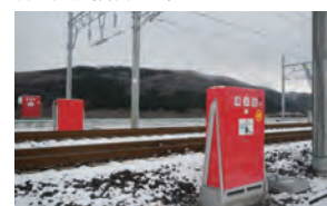
地上消火設備(湯の里知内信号場)
