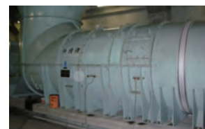
排煙設備(吉岡定点)
