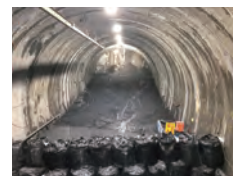
渡島トンネル(台場山工区) 坑内への土砂流入 提供: 鉄道・運輸機構
