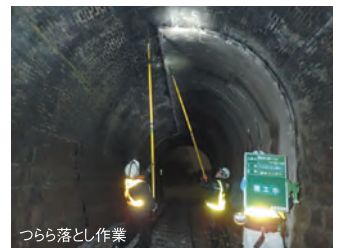
塩谷トンネル [経年、漏水の凍結など] ○経年112年(1913年完成) ○函館線 塩谷～小樽 間
