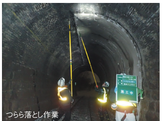
塩谷トンネル [経年、漏水の凍結など] ○経年111年(1913(大正2)年完成) ○函館線 塩谷～小樽 間
