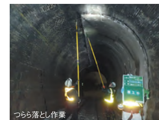
塩谷トンネル [経年、漏水の凍結など] ○経年113年(1913年完成) ○函館線 塩谷～小樽 間
