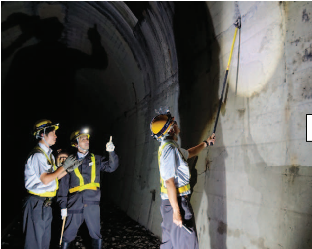
トンネル壁面の変状を目視により確認
