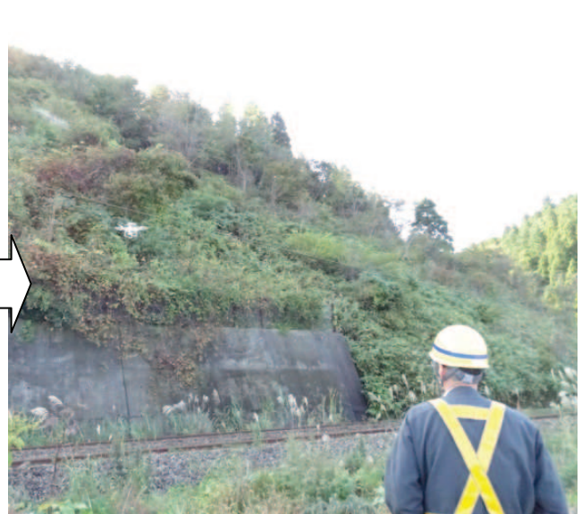
斜面の変状をドローンにより撮影
