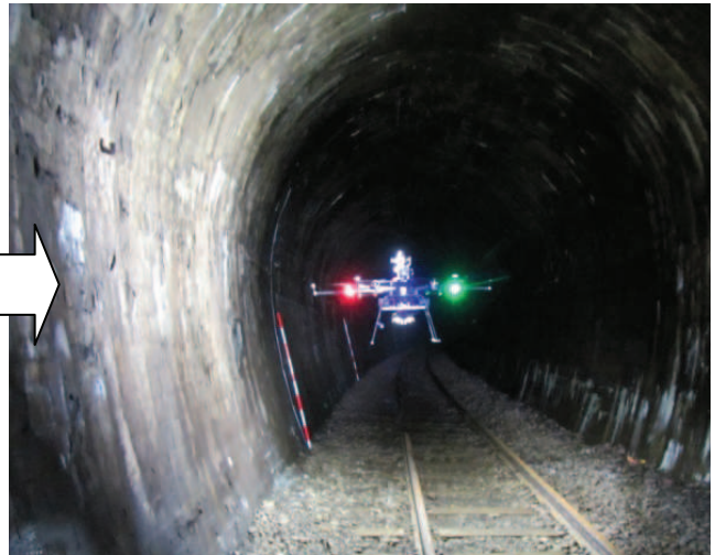
トンネル壁面の変状をドローンにより撮影
