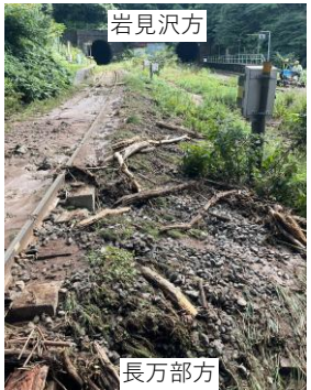
【被災箇所⑩】土砂流入 静狩～小幌（下り線） 17k390m付近
