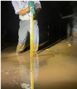
【被災箇所⑧】線路冠水 静狩～小幌（下り線） 15k410m付近～
