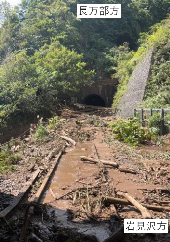
【被災箇所⑥】土砂流入 静狩～小幌（上り線） 15k475m付近
