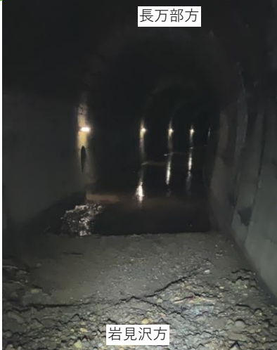
【被災箇所⑤】土砂流入 静狩～小幌（上り線） 15k370m付近
