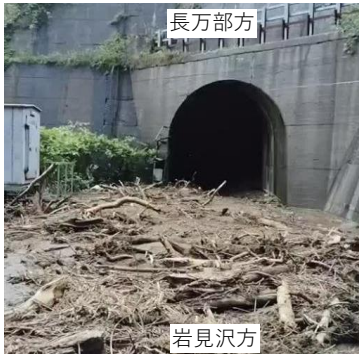
【被災箇所⑦】土砂流入 静狩～小幌（下り線） 15k377m～407m
