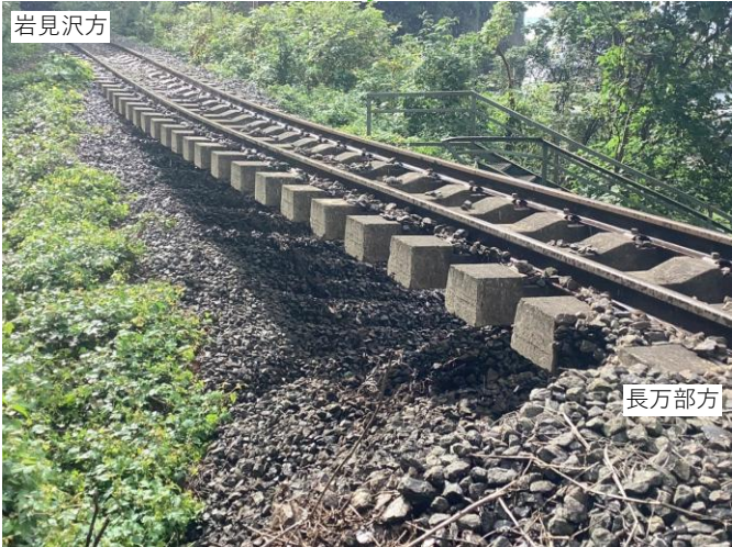
【被災箇所③】路盤流出 静狩～小幌（上り線） 12k143m～156m
