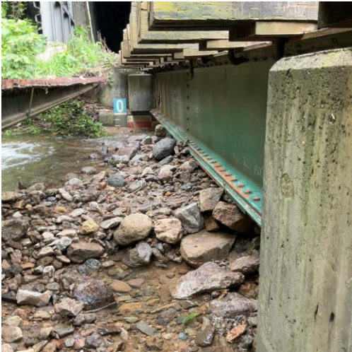
【被災箇所④】橋りょう閉塞 静狩～小幌（上り線） 12k623m付近
