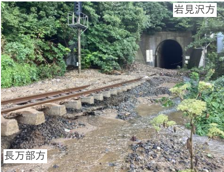
【被災箇所①】道床流出 静狩～小幌（下り線） 12k150m～160m
