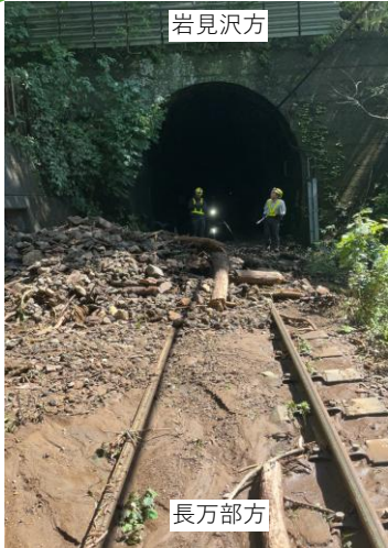
【被災箇所⑨】土砂流入 静狩～小幌（上り線） 16k481m付近
