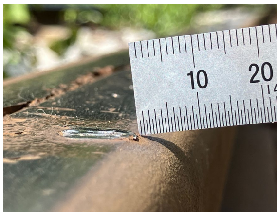
レールの表面に圧着した金属片
