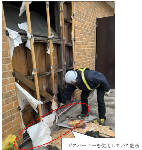
焼損箇所(消火後)写真
