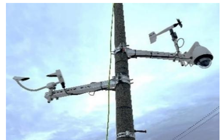
視程計の設置
