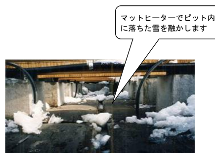
ポイント融雪ピット内の状況
