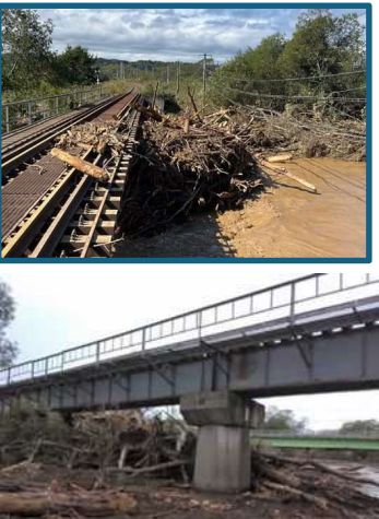
【被災箇所⑦】流木堆積 直別（信）【直別川橋りょう】 259k416m
