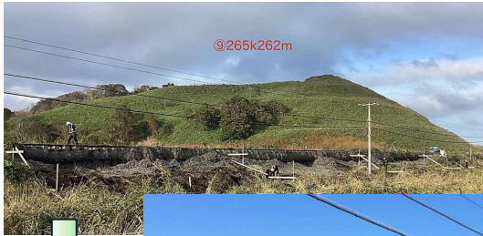
【被災箇所⑤】 路盤・道床流出 265k263m～330m
