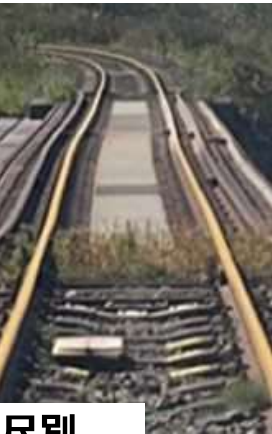
【被災箇所①】 通り変位（橋りょう上）
