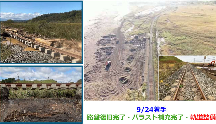
【被災箇所⑨】道床流出・路盤流出 尺別（信）～音別 264k900m～265k330m
