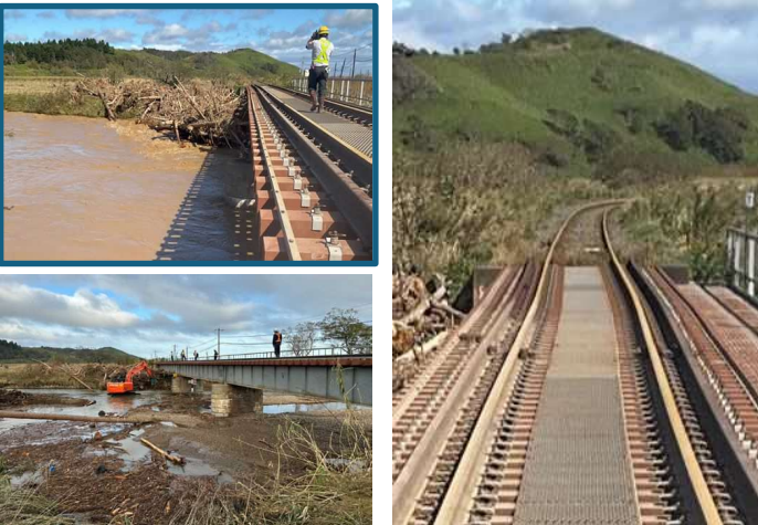
【被災箇所⑧】流木堆積・通り変位 尺別（信）～音別【尺別川橋りょう】 264k683m
