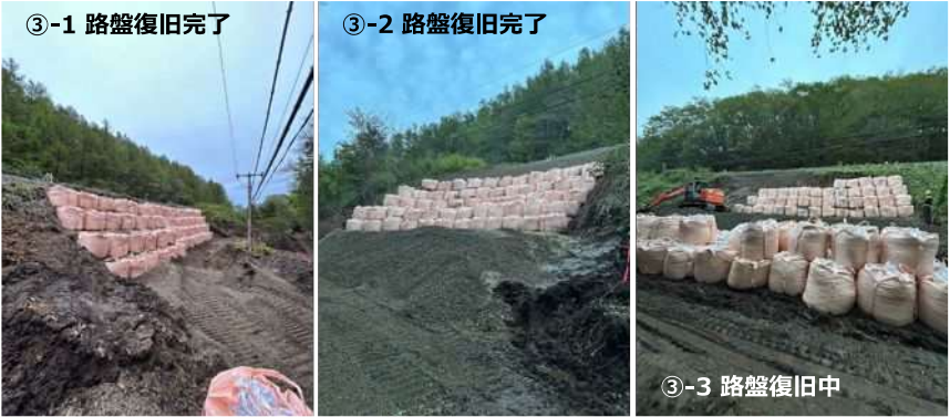
【被災箇所③】路盤流出 常豊（信）～上厚内（信） 239k682m～973m（3箇所）
