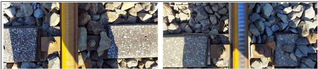
写真 1. レール表面状況
