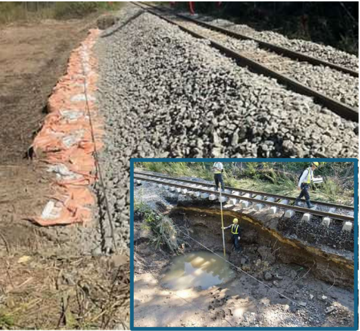
【被災箇所⑥】路盤流出 常豊（信）～上厚内（信） 243k618m～653m
