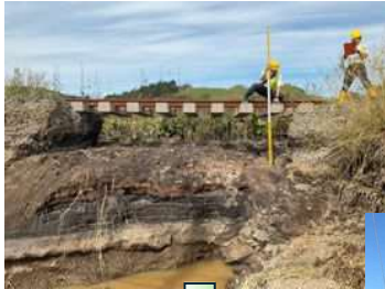
【被災箇所④】 路盤・道床流出 265k244m～255m
