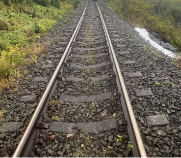
【被災箇所①】路盤流出 十弗～豊頃 218k361m～367m
