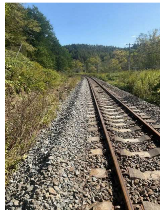
【被災箇所⑤】道床流出 常豊（信）～上厚内（信） 242k580m～620m
