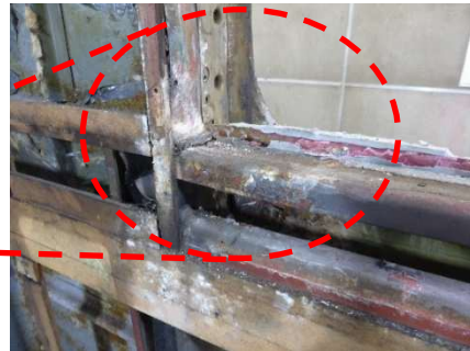
腐食大、穴あき
