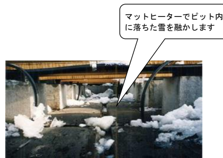
ポイント融雪ピット内の状況
