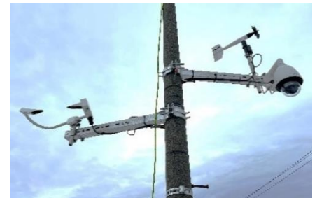
視程計の設置
