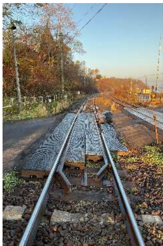
鷺ノ木道路踏切下り線（脱線事故直後）
