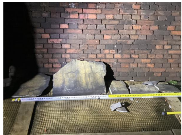
写真2 剥落したモルタル片
