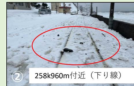
高波により石が打ちあがった状況
