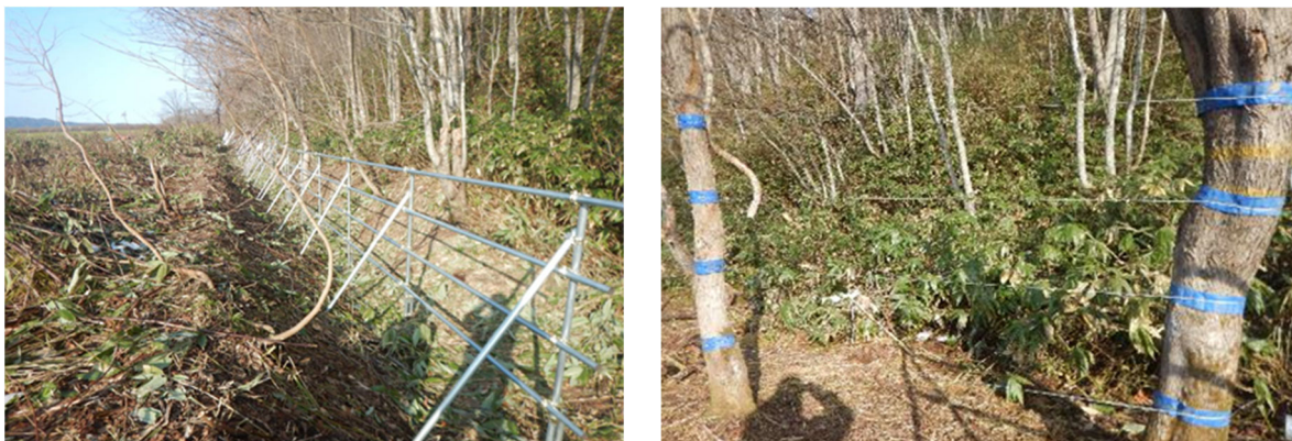
<線路脇に設置している鹿侵入防止柵（宗谷線）>
