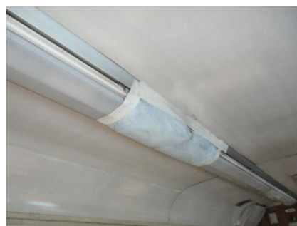
雨漏りの発生
