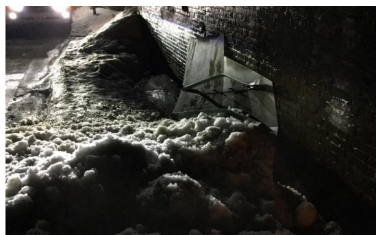
写真2 落下した防塵板と堆積していた雪
