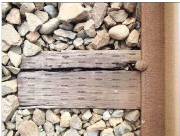
写真3. 割れたマクラギの例（施工前）
