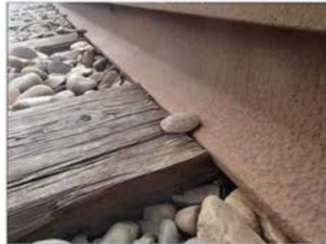
レールのマクラギへの食い込み
