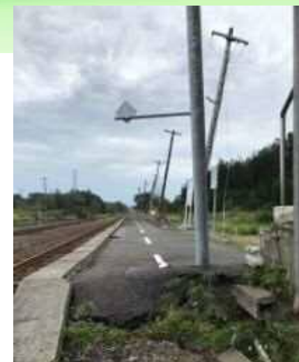
室蘭線 安平駅構内 電柱傾き
