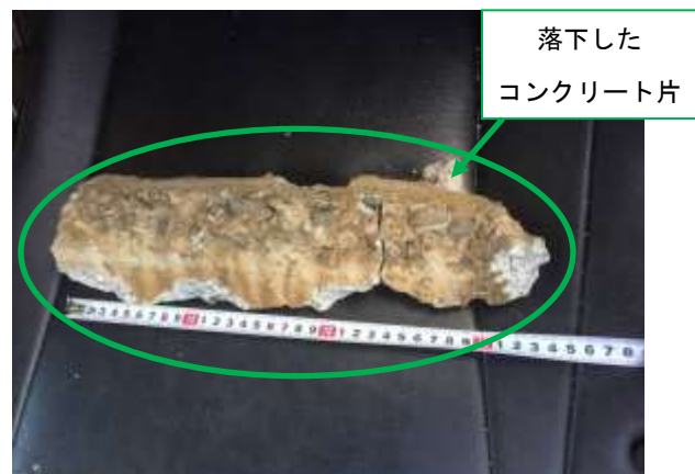
写真2 落下したコンクリート片
