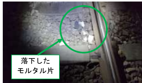
写真 2 落下したモルタル片
