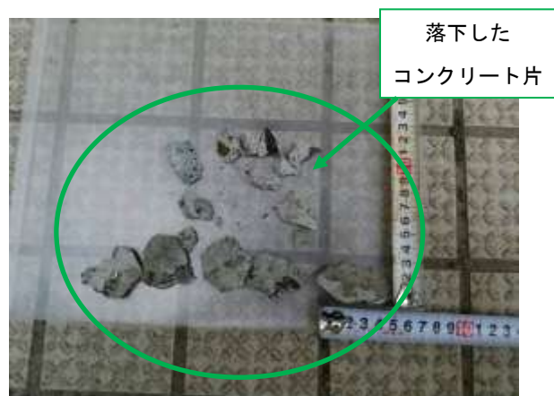
写真2 落下したコンクリート片
