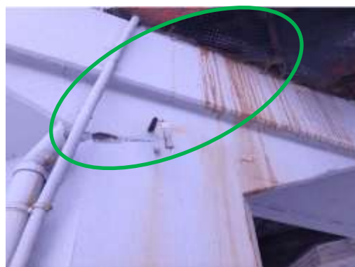
写真2 排水管落下箇所
