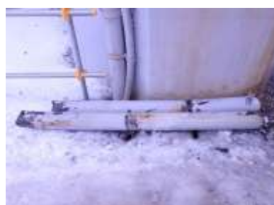
写真3 落下した排水管
