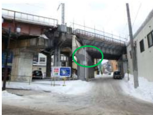
写真1 排水管落下箇所全景
