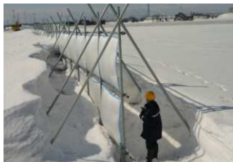
防雪柵の状況
