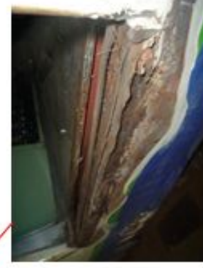
側引戸部腐食
