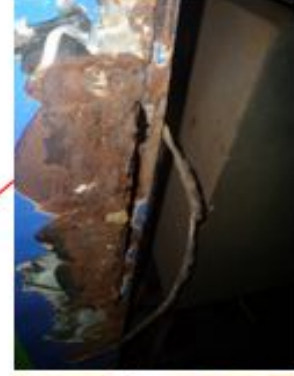
側構体部腐食
