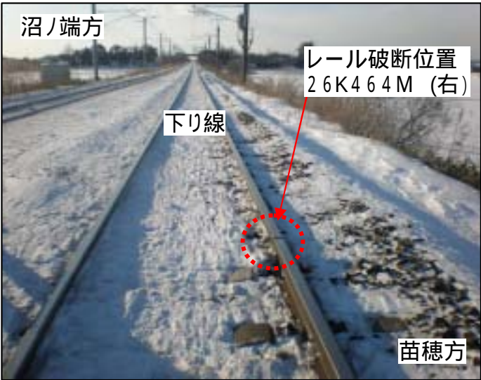
【レール破断状況】
