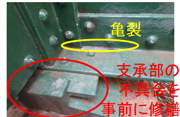
亀裂が発生した橋りょう
