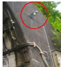
トンネル出入口の照明
