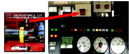
左：ブレーキシリンダー部に取り付けられたセンサー 右：運転台に取り付けられたアラートランプ
