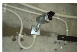
陸底部斜坑のカメラと放送設備
