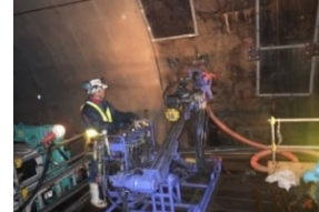
トンネル変状対策
