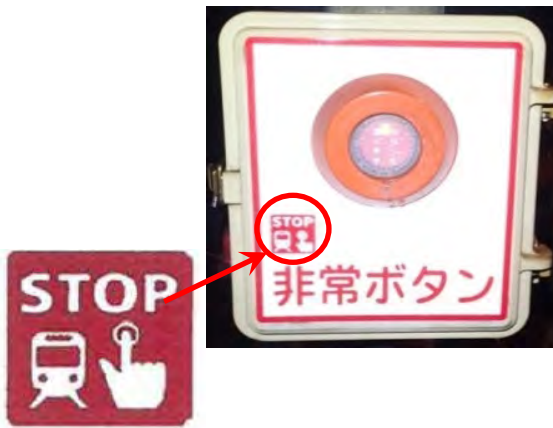
ピクトグラムを表記した踏切支障報知装置非常ボタン
