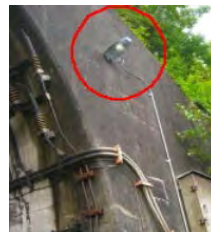
トンネル出入口の照明
