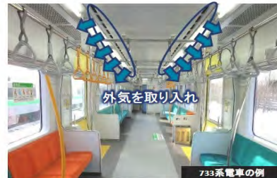
733系電車の例 空調設備による車内換気（通勤列車）
