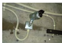
陸底部斜坑のカメラと放送設備
