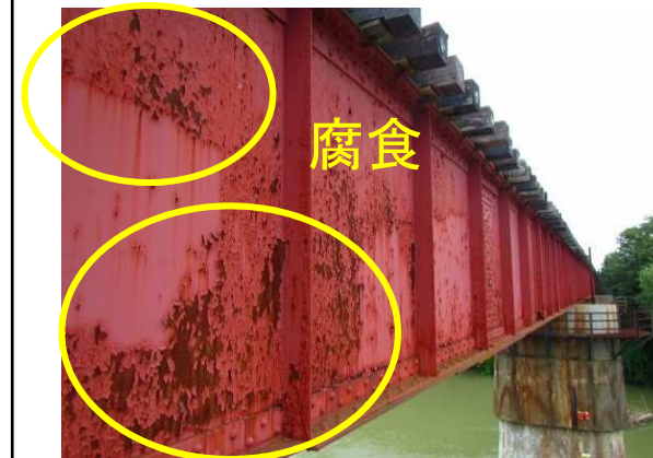
腐食が発生した橋りょう
